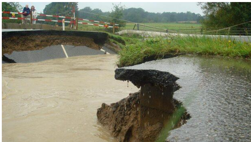
Figur 14 Landevejen ved Adsbøl blev skyllet væk under det ekstreme skybrud (Kilde: TV2 vejret)
