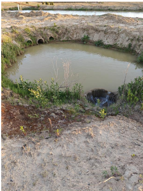
Figur 11: Lille vandhul med meget stejle brinker og lodret udløb samt flere dræntilløb. FOTO: NIRAS 31. maj 2023.
