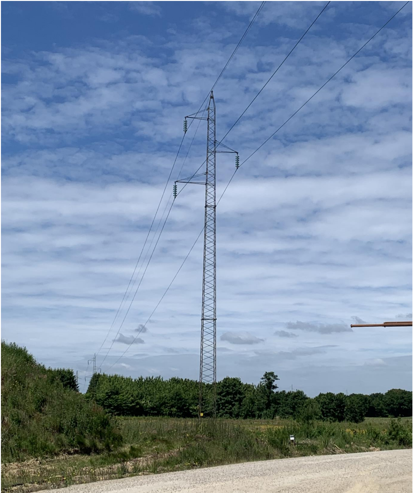
Figur 14.1: Vestlige elmast vest for adgangsvejen på matr. nr. 3a Asklev By, Them. Foto: NIRAS, 21. juni 2022.
