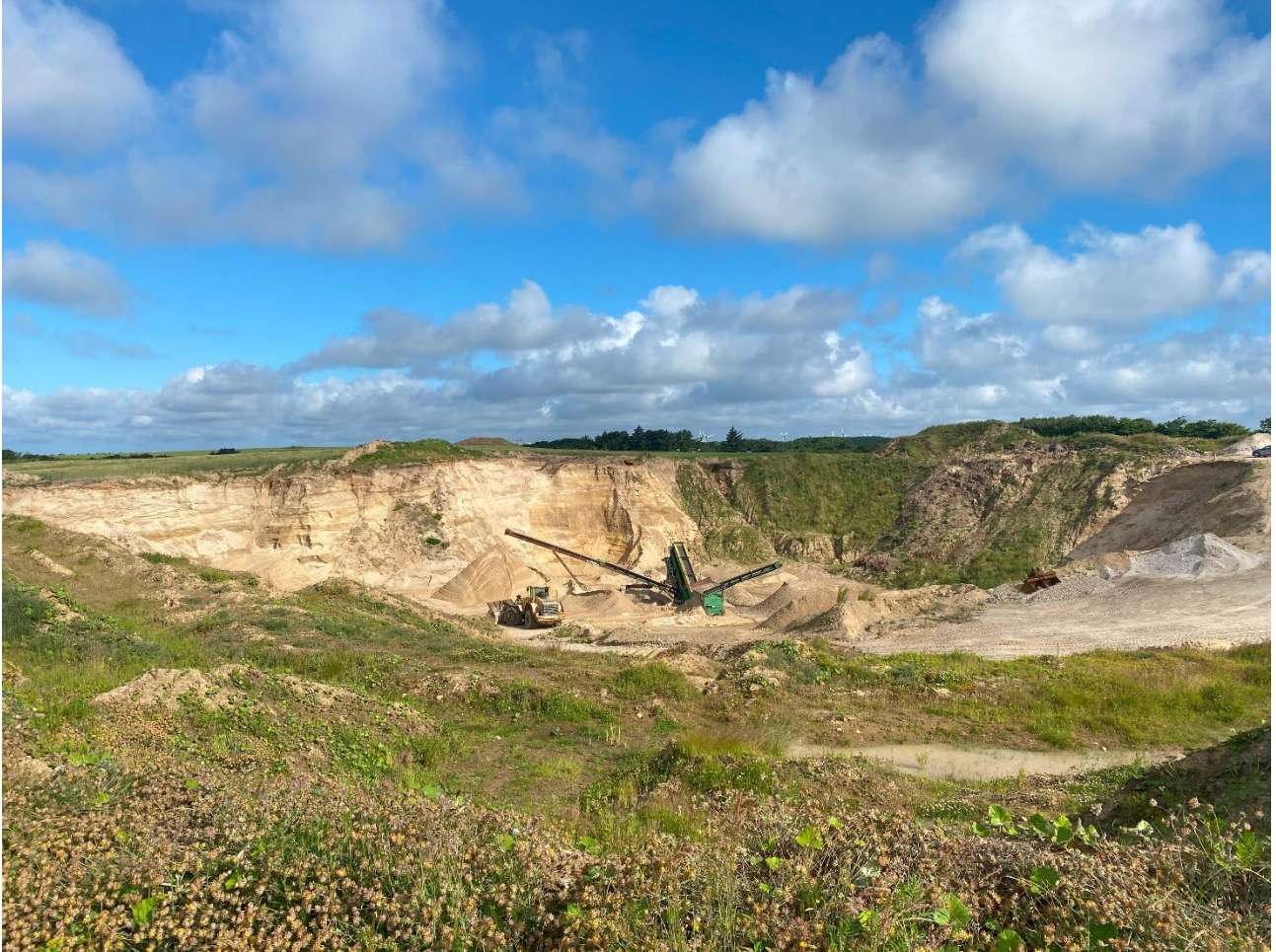
Figur 6. Sydvendt skråning i baggrunden med varieret overfladestruktur.
