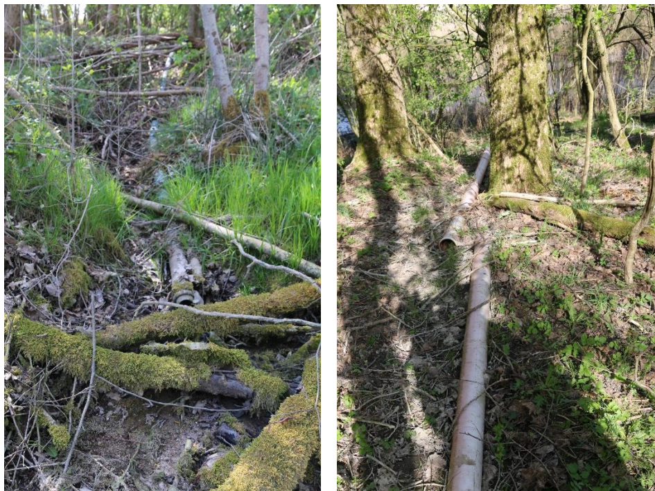
Figur 1.3: To af de steder hvor rørledningen er brudt. Til venstre, det første sted rørledningen er afbrudt. Til højre rørledning hvor samlingen er forskubbet. Foto: 23-04-2019 Dansk Bioconsult Aps.
